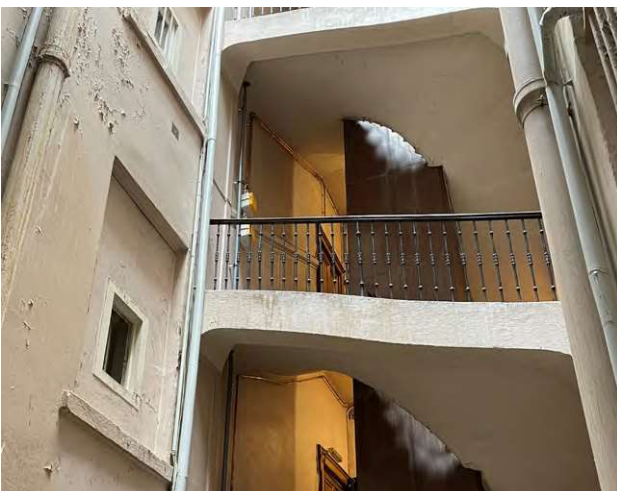
Exemple d'escalier tronqué au profit d'un ascenseur. Bruno Dumétier
