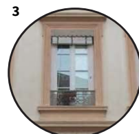
3 Protections solaires : jalousies lyonnaises
