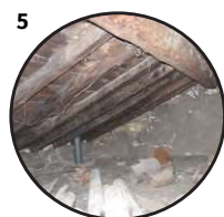
5 Combles non isolés par endroit > défavorable au confort d'été
