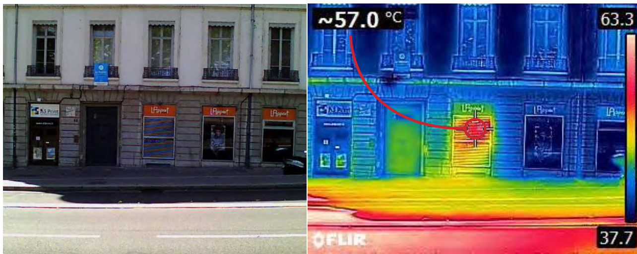
Exemple du commerce/service "L'Appart" avec extraction d'air de climatisation en façade, 1 Quai Jean Moulin. Photographie et prise de vue de caméra thermique, Tribu
